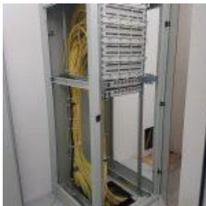
Serverschrankverkabelung Klatt EDV Berlin
